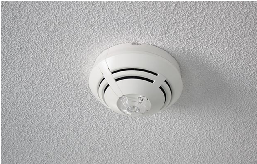
Abbildung 1: Nicht in allen Instituten zu finden: Ein Brandmelder. Bildquelle: https://sicherungstechnik-franz.de/wp-content/uploads/Sicherungstechnik-Franz-Mengkofen-Leistung-BMA.jpg [aufgerufen 26.03.2024].
